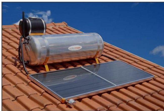
Figura 1 - Sistema de Aquecimento Solar
