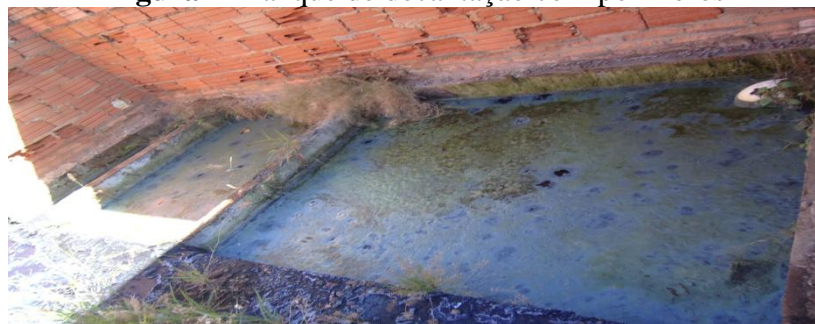
Figura 4- Tanque de decantação com polímeros
