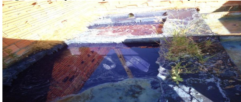
Figura 3- Tanque de adição de sulfato ferroso para decantar
