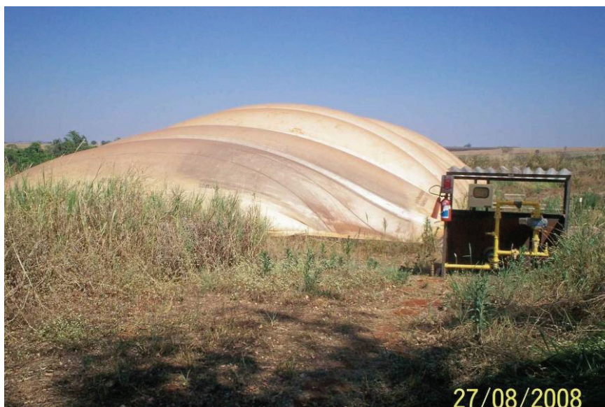
Figura 18 – Biodigestor Fonte: Produzida pelo autor (2008).
