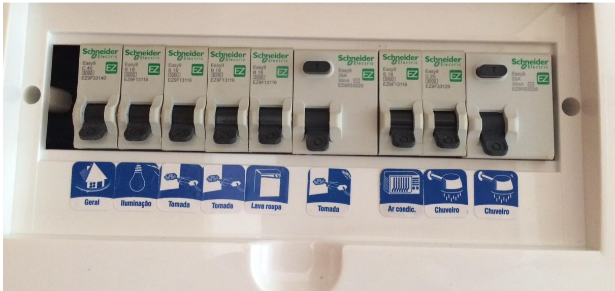
Figura 1 - Quadro de Distribuição (Disjuntores)
