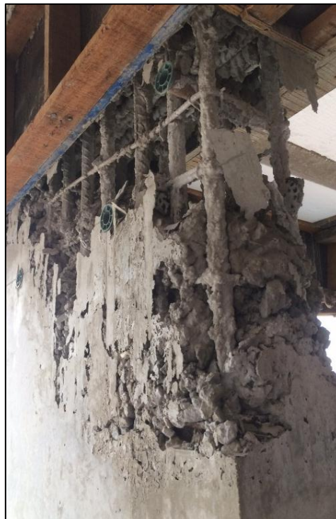
Figura 19 – Vazios de concretagem
