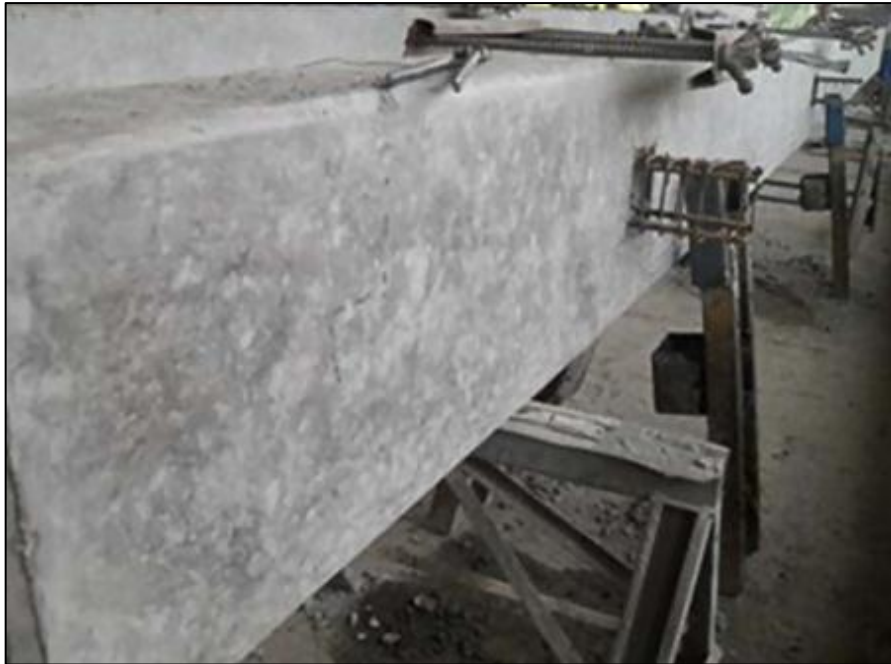
Figura 16 – Manchas no concreto
