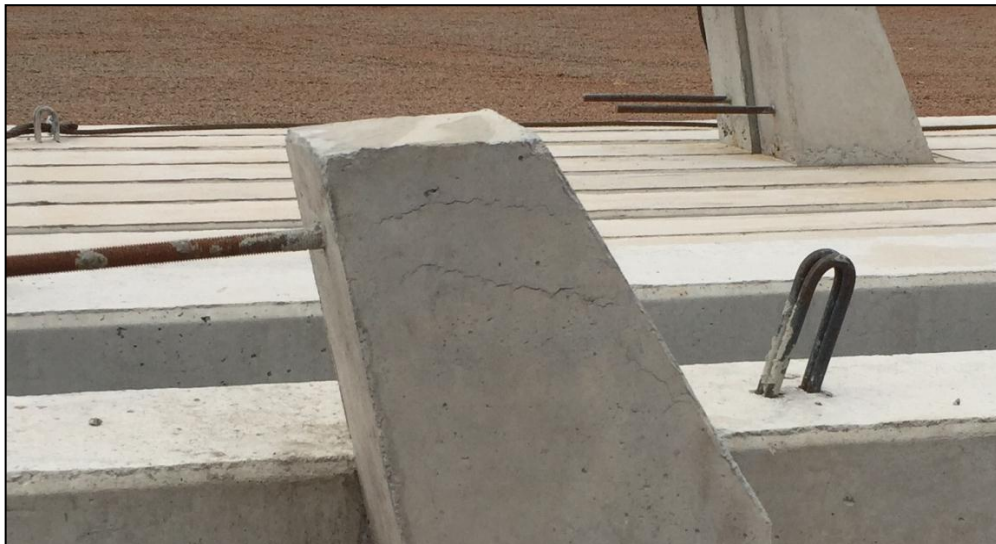
Figura 33 – Presença de fissuras, empresa 1
