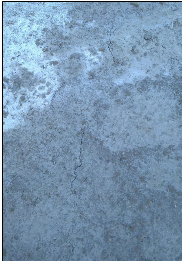
Figura 17 – Fissura no Concreto
