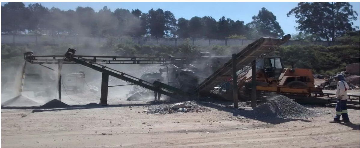
Figura 12 - Maquinário da Usina de reciclagem
