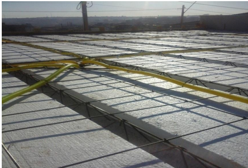
Figura 26 – Passagem da rede elétrica
