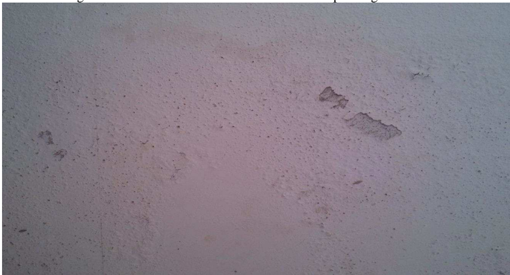
Figura 38: Manchas e eflorescência ocasionadas pelas águas da chuva
