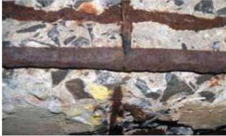
Figura 41: Degradação da ferragem
