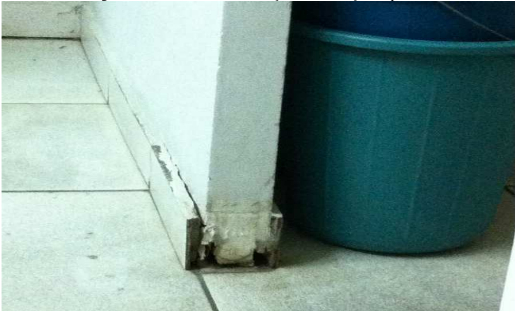
Figura 50: Cozinha/Área de Serviço – Deterioração da parede.
