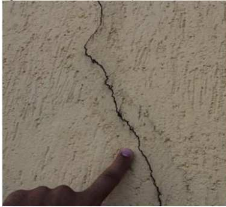
Figura 39: Exemplo de Fissura
