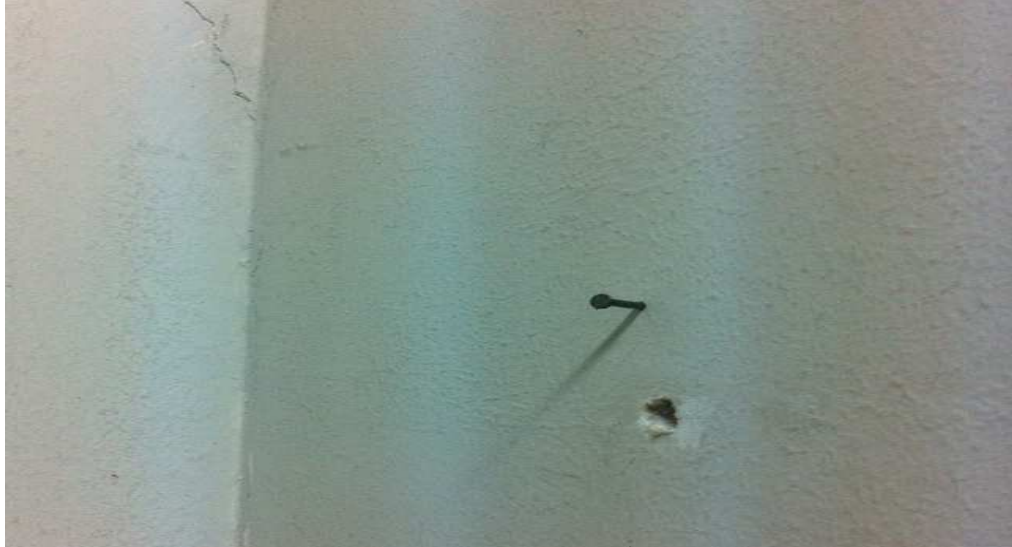
Figura 53: Ambiente de uso geral – Fixação inadequada.
