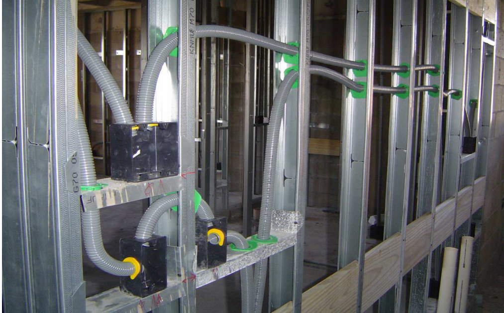
Figura 25: Tubulação Elétrica Na Estrutura Da Pared
