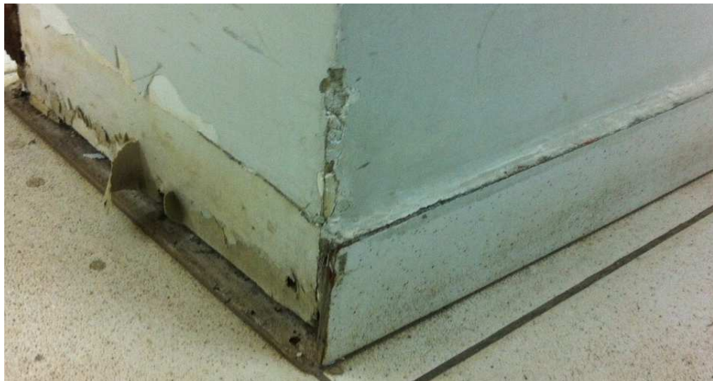
Figura 44 Detalhe da Figura 43 – Parede de gesso deteriorada
