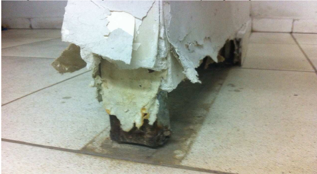
Figura 49: Detalhe da Figura 48 indicando a deterioração da placa e perfil metálico.
