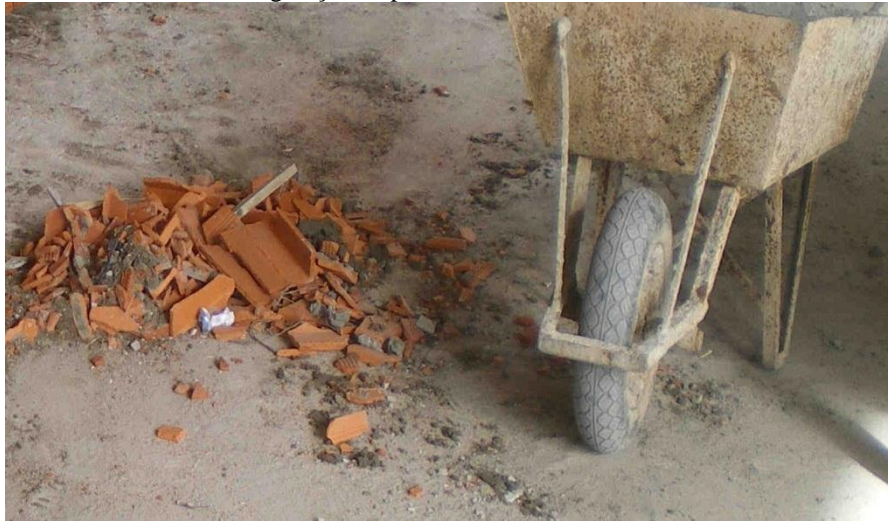
Figura 37 - Varrição do canteiro com a umificação da superfície, evitando a geração de poeira.
