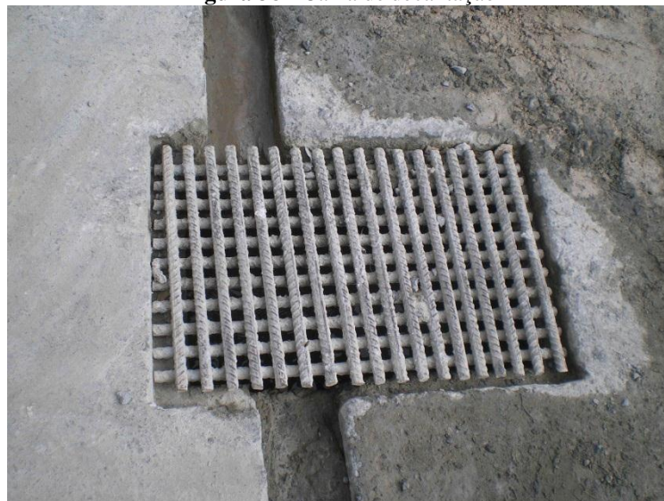
Figura 38 - Caixa de decantação
