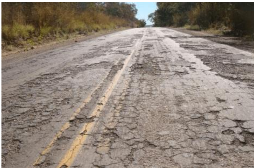
Figura 6: Patologias de trinca e desgaste.
