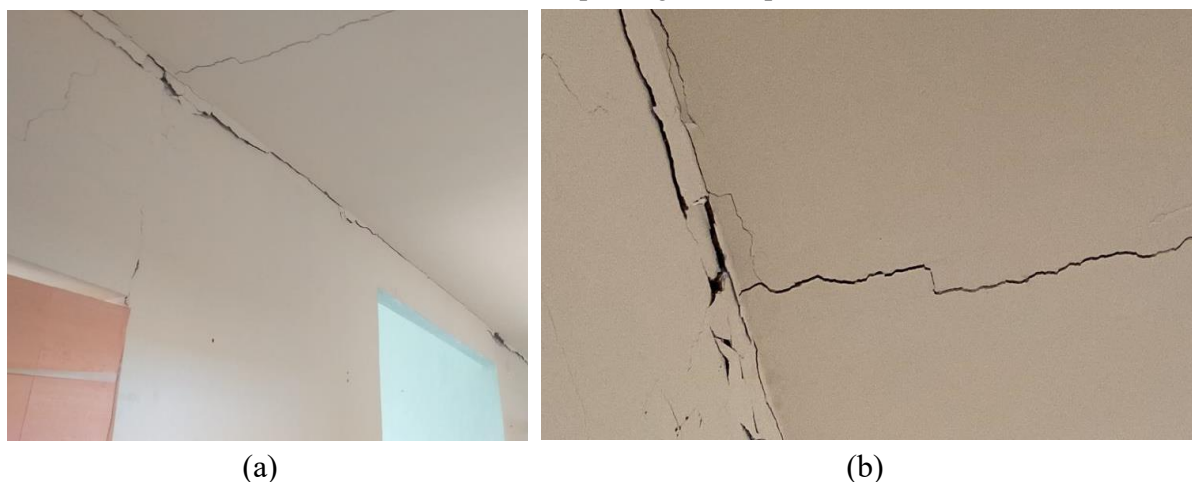
Figura 10 – Rachaduras encontradas no corredor da edificação: (a) com trincas descendentes na alvenaria; (b) na alvenaria e teto com prolongamento pela extensão do mesmo.
