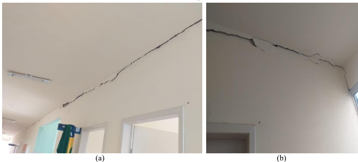
Figura 9 – Rachaduras encontradas no corredor da edificação: (a) em todo o teto; (b) ao longo do teto, terminando na esquadria.
