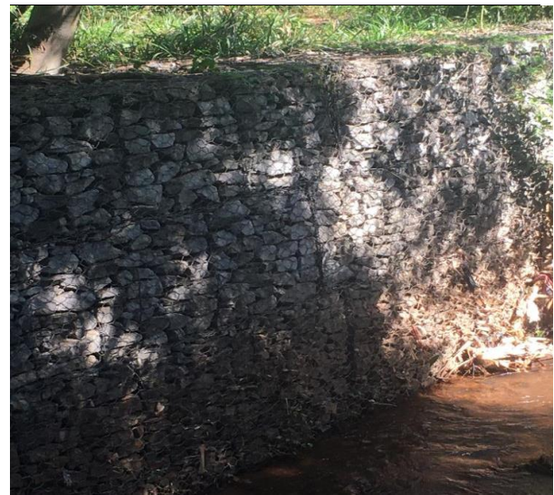
Figura 36 - Uso do gabião no parque do praia no Bairro JK.
