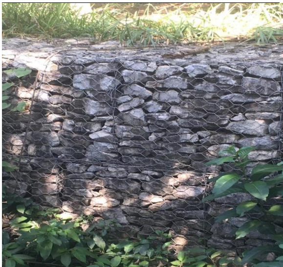
Figura 35 - Uso do gabião no parque do praia no Bairro JK.
