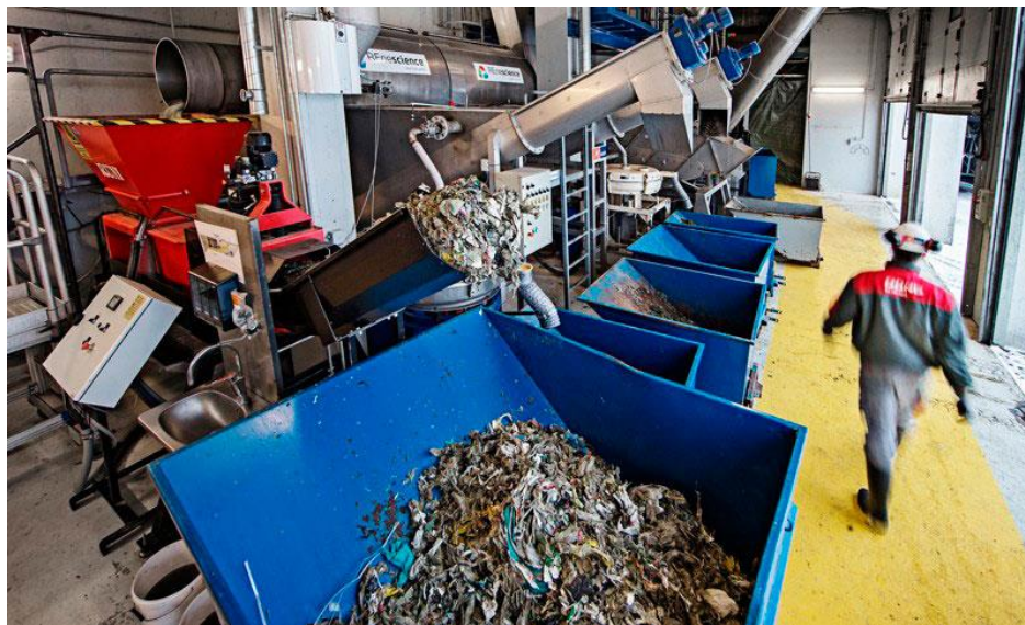
Figura 25 – Caçambas receptoras dos resíduos triturados
