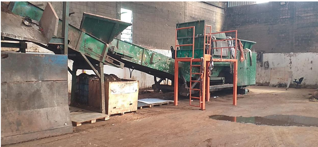
Figura 20 – Triturador de Resíduos Sólidos
