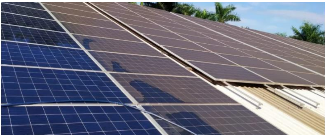
Figura 14 - Placa com sujeira acumulada
