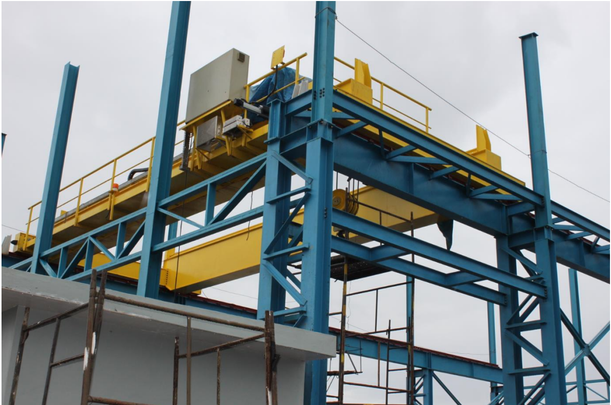
Figura 31-Conjunto de Ponte Rolante com Viga de Rolamento Treliçada
