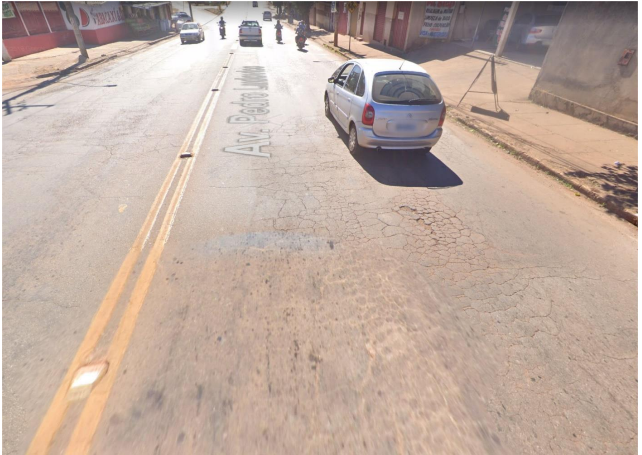
Figura 33: Trecho com buracos e fissuras.
