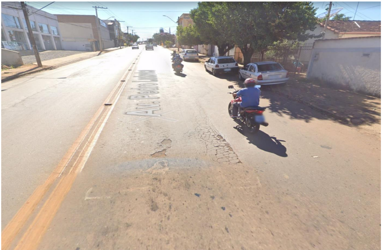
Figura 32: Trecho com buracos e trincas
