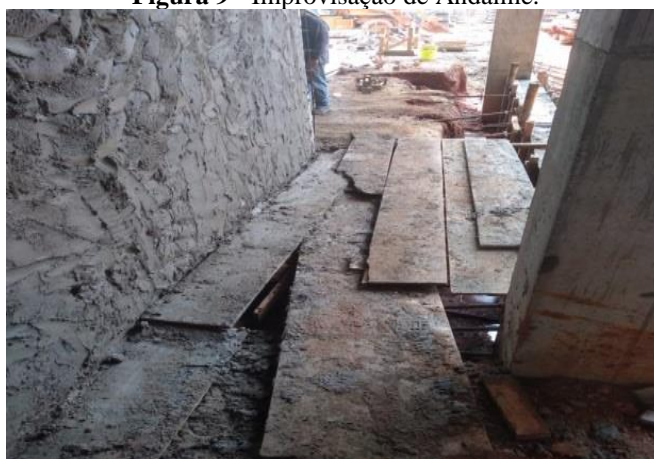
Figura 9 - Improvisação de Andaime.
