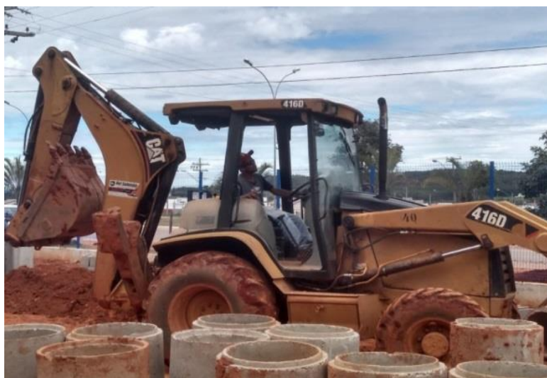
Figura 6 – Funcionário sem treinamento manuseando máquinas.
