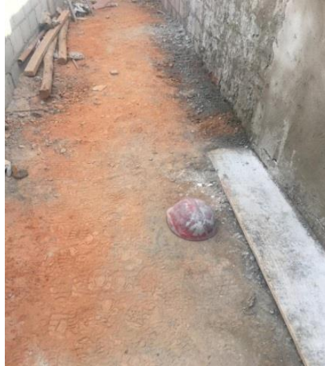
Figura 4 - Falta de cuidado com os EPI's.
