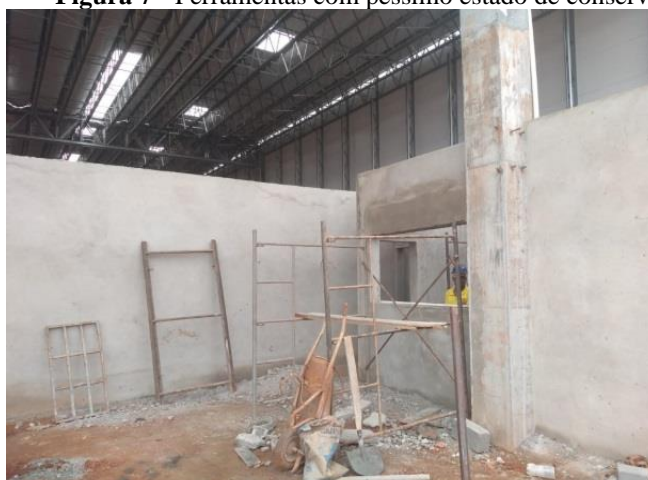
Figura 7 - Ferramentas com péssimo estado de conservação.
