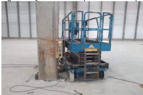
Figura 10 - Quadro de distribuição em má conservação.
