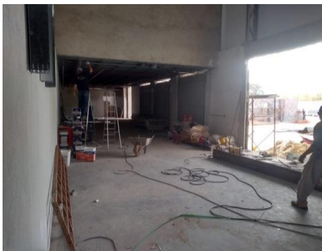
Figura 5 - Falta de sinalização na área de risco elétrico.
