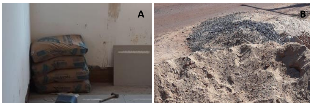
Figura 6 – Armazenamento do cimento (a), agregado graúdo e miúdo (b) utilizados na dosagem do concreto da obra 5.
