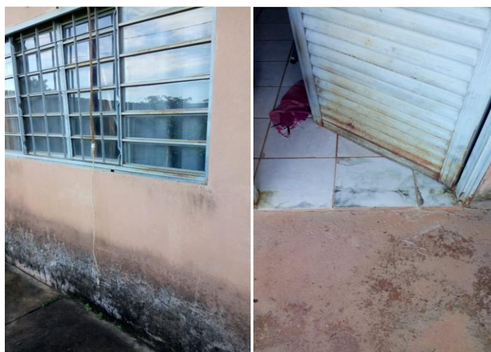
Figura 14 - Portas e janelas oxidadas. Fonte: (GOMES; OLIVEIRA, 2019)
