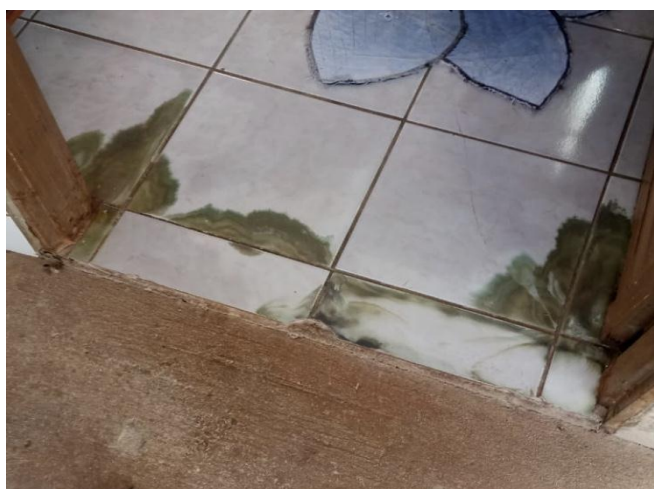
Figura 9 - Eflorescência em piso.
