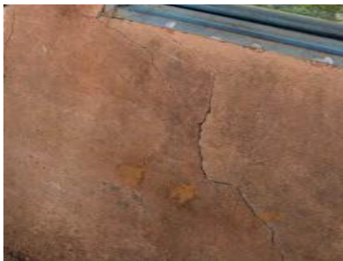
Figura 04 – Fissuras em vedação externa
