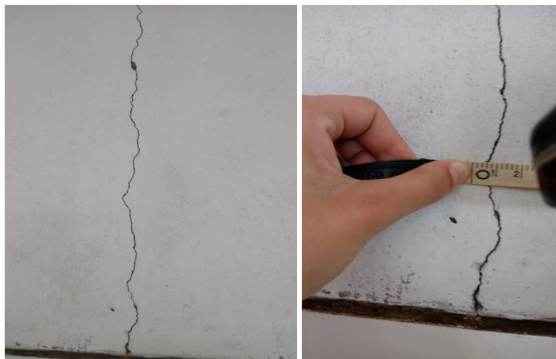
Figura 05 – Trinca em ambiente interno (cozinha) com abertura de 2 mm
