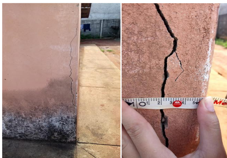
Figura 06 – Trinca em vedação externa com abertura de 2 mm
