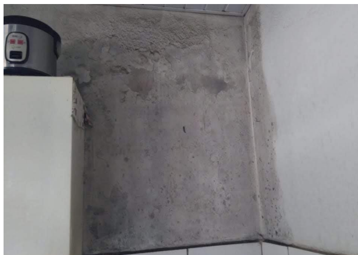
Figura 13 – Infiltração na parede interna da cozinha de uma residência
