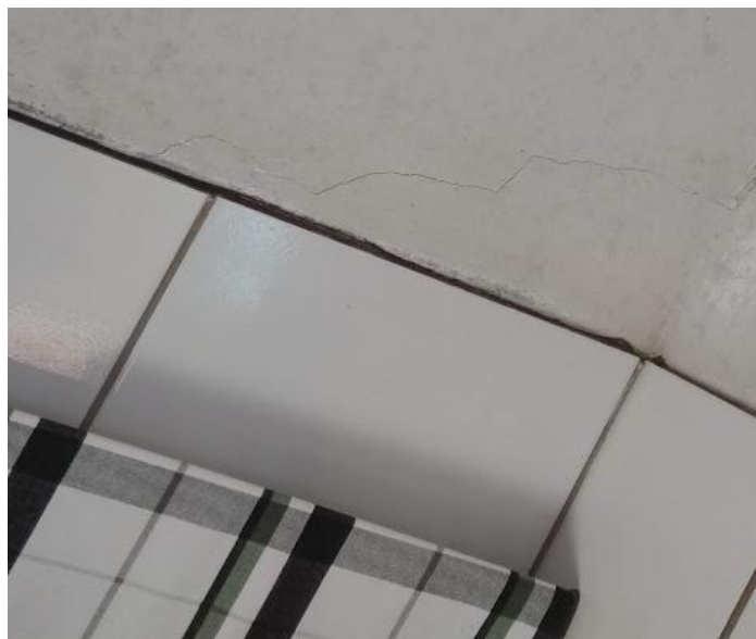
Figura 03 – Fissuras encontradas em ambiente interno
