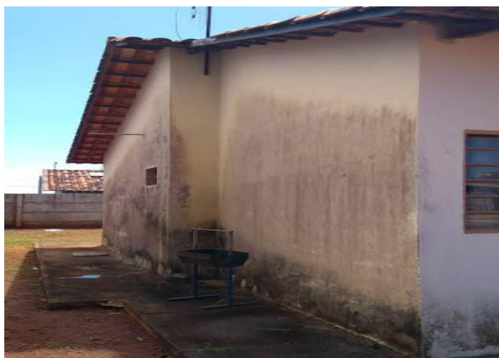
Figura 12 – Vedação externa contendo infiltração
