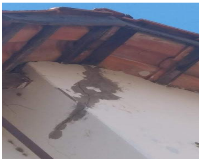
Figura 07 – Manutenção realizada em trinca
