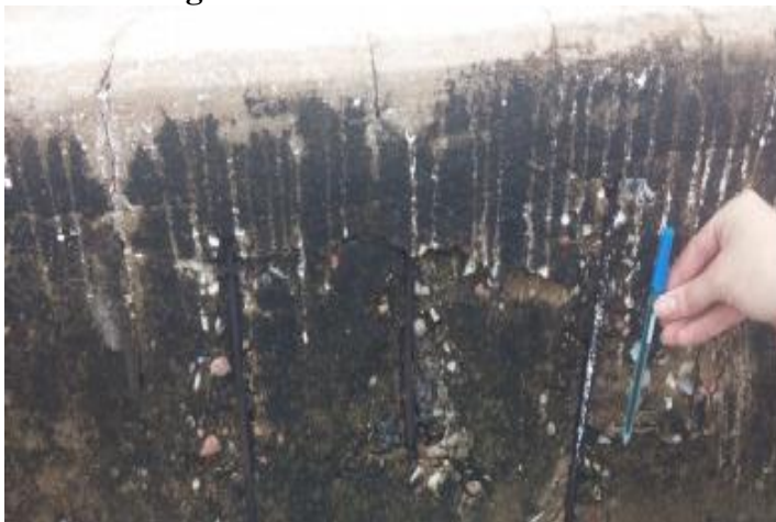
Figura 5. Corrosão das armaduras
