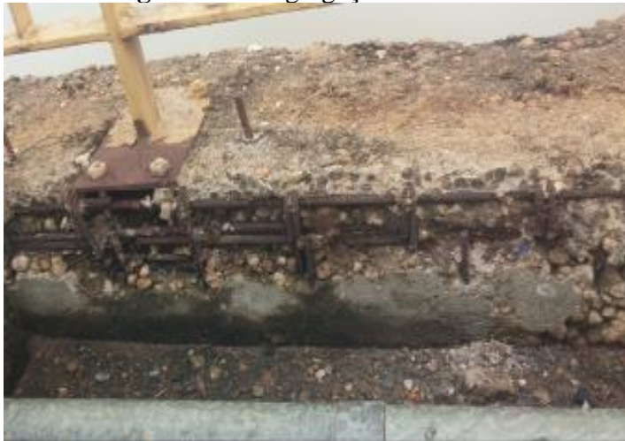
Figura 4. Desagregação do concreto
