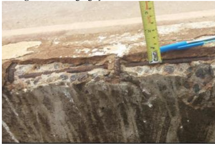
Figura 3. Desagregação e corrosão da armadura
