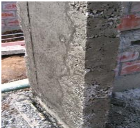
Figura 6. Segregação em Pilar
