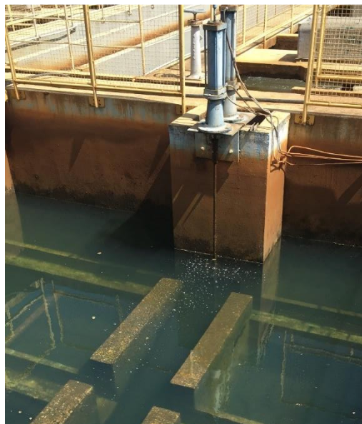
Figura 7 - Decantação por gravidade
